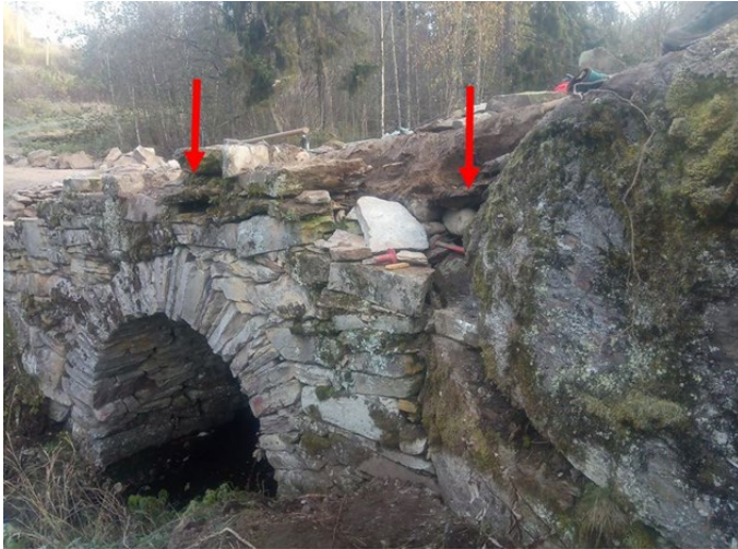
Figur 4 Pilene viser parti med skadar/manglar nedstraums. Demontering og oppattbygging var nødvendig. Foto: Haakon Aase
