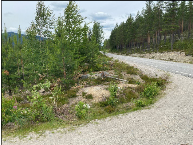
Bildet viser siktforholdene mot nord for dagens situasjon ved utkjøring på fv.2188. Oppslag av vegetasjon er til hinder for frisikten.
